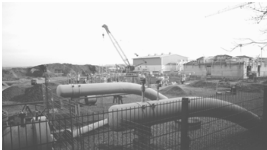
Industriestandort Haiming: Unterhalb des Wackerberges sind die künftigen Veränderungen bereits sichtbar: Hier entsteht die Gasverdichterstation.
