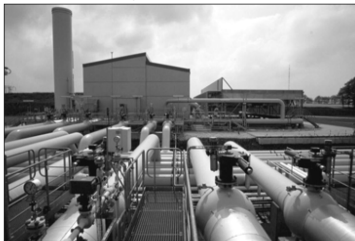
Außenansicht einer Station mit Kompressor-Gebäude in der Mitte, links Abgaskamin, rechts Kühlanlage für das komprimierte Gas
