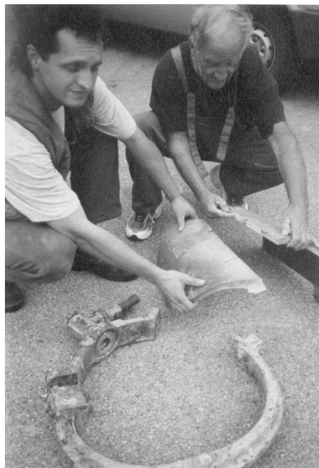
Die Wasserwarte Erich Mayer (rechts) und Christian Brenninger zeigen den Bruch im 400er PVC-Rohr
