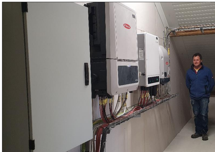
Die neue Prozesssteuerung zur Einbindung der PV-Anlagen in den Betrieb der Kläranlage. Die Gesamtplanung dafür hatte Horst Eger.
